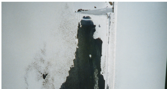
Abb. 2.3.1 Pulverschicht rutscht teilweise ab
