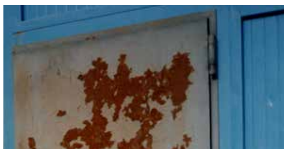
Fig. 5.2.3 Escoria, oxidación superficial, óxido blanco
