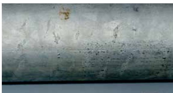
Fig. 3.5.8 Galvanizado por inmersión en caliente defectuoso
