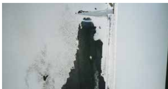
Fig. 2.3.1 Partes de capa de polvo se desprenden
