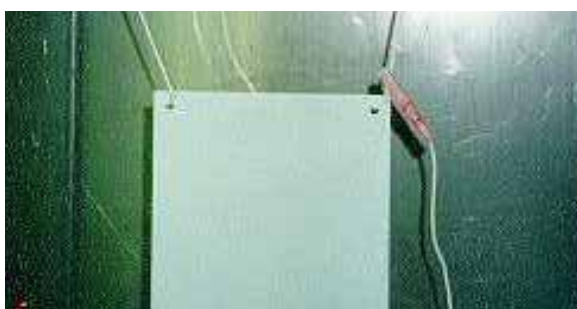
Fig. 2.3.3 Pas mise à la terre ou mise à la terre insuffisante
