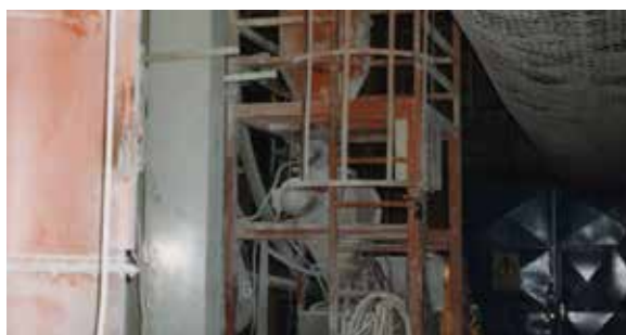
Fig. 6.1.1 Restes de poudre ou impuretés dans la cabine d'application contamination croisée
