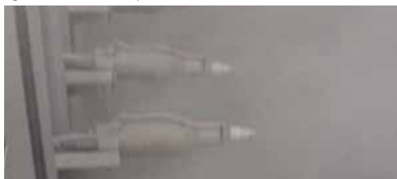
Fig. 2.1.3 Fluidisation insuffisante - Volume de poudre trop grand
